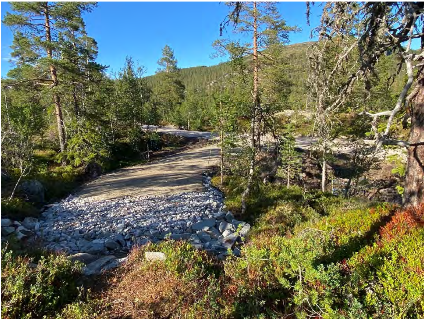
Opparbeidet innkjøring til tomtegrense. Blindvei til høyre, som går over til regulert turvei til Trillemarka
